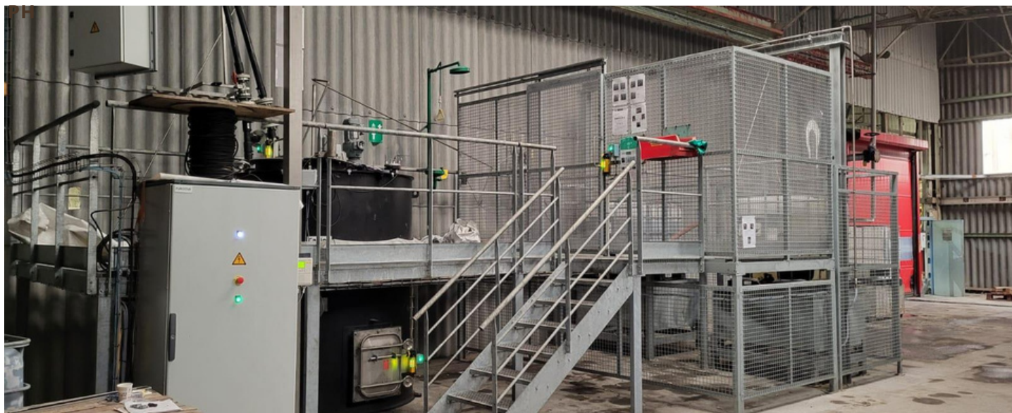
station de traitement d'eau
