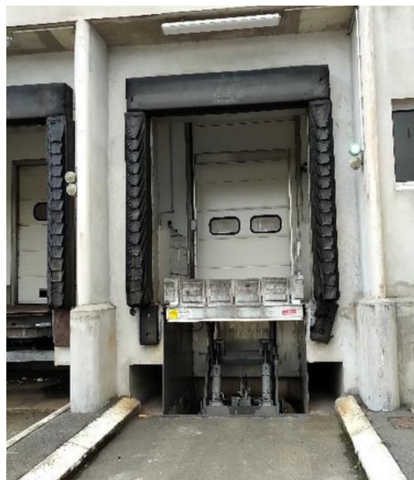
entretien quai niveleur
